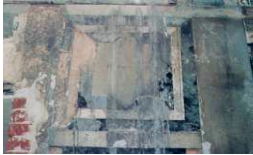
ج- الترميم الخاطئ باستخدام الطوب الأحمر والجبس
