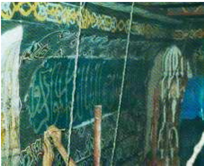
بعض أجزاء من جدار رواق القبلة في المدرسة الجوهريّة أثناء عمل الرتوش للترميم الدقيق
